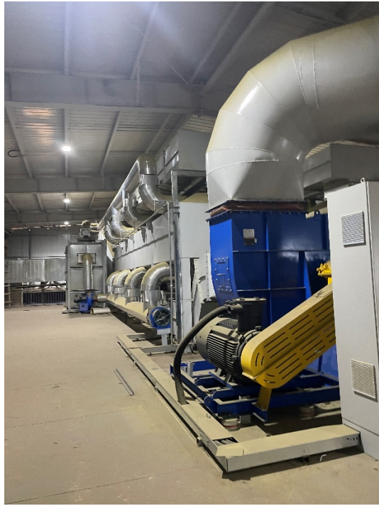
调漆、喷漆、晾干废气处理设施
