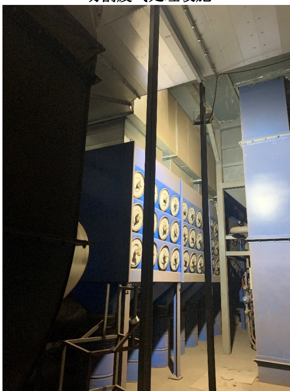
喷砂废气处理设施
