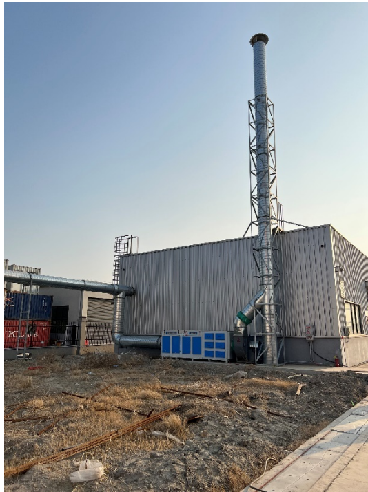
危化品仓库、危废仓库废气处理设施
