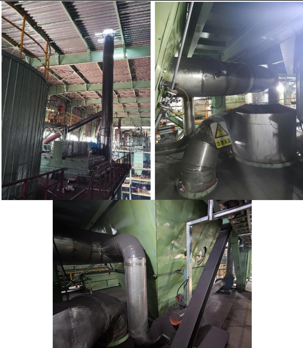
图 3-6 喷雾造粒、燃烧、包装废气旋风除尘+脉冲布袋除尘装置及排气筒照片
