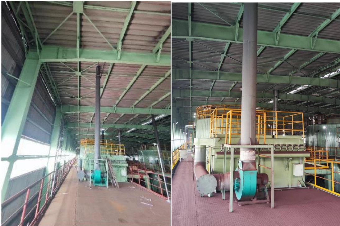
图 3-5 计量料仓呼吸废气及振磨、输送废气脉冲布袋除尘装置及排气筒照片
