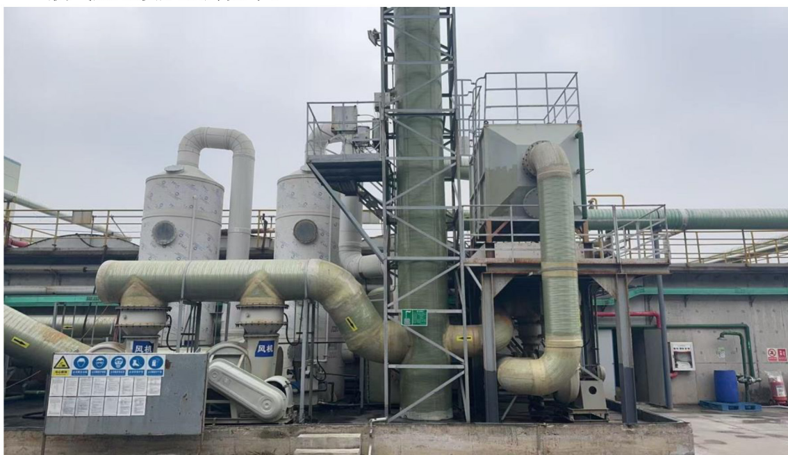
DMAC 精馏区二废气处理设施
