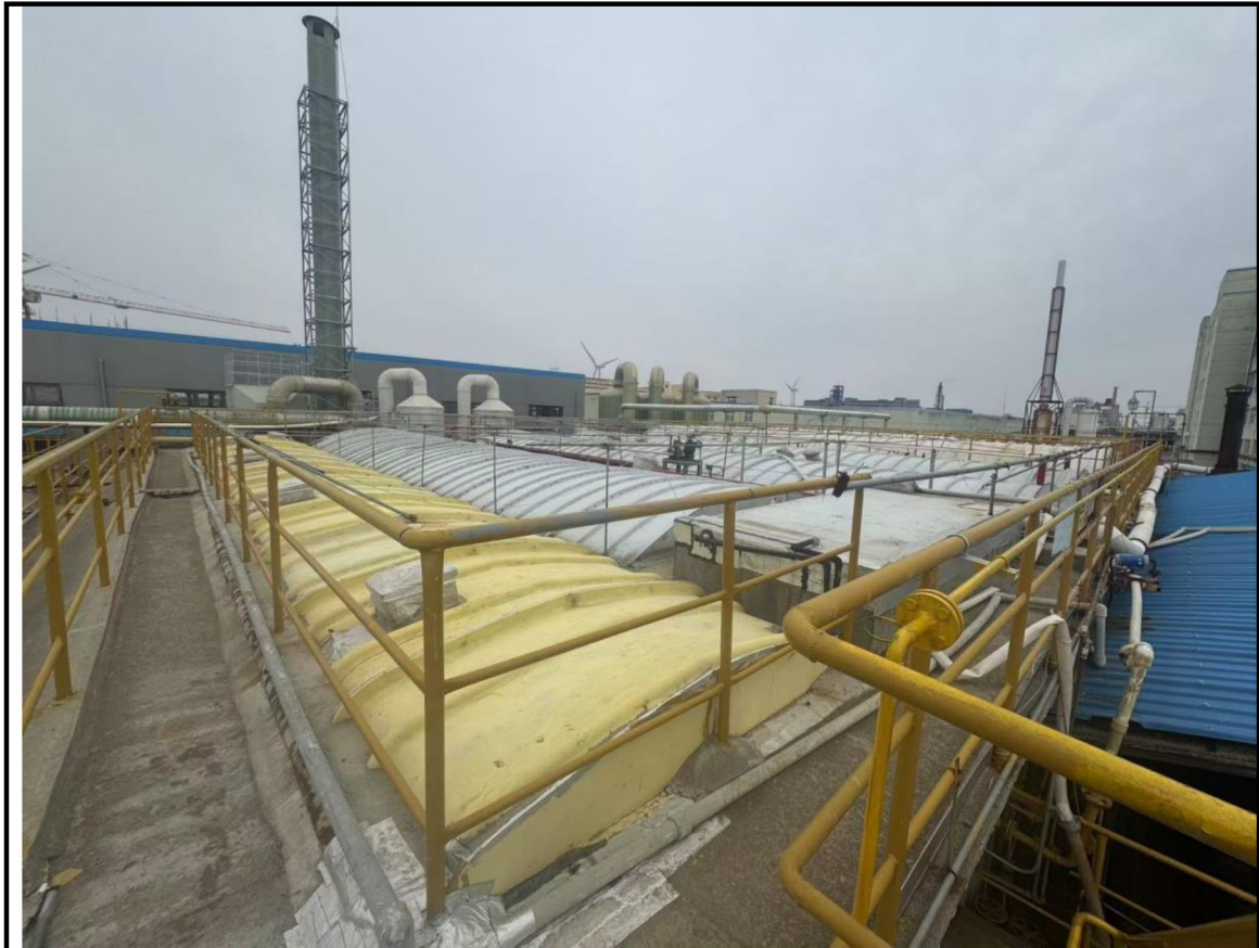
图 3-4 污水处理站设施照片
