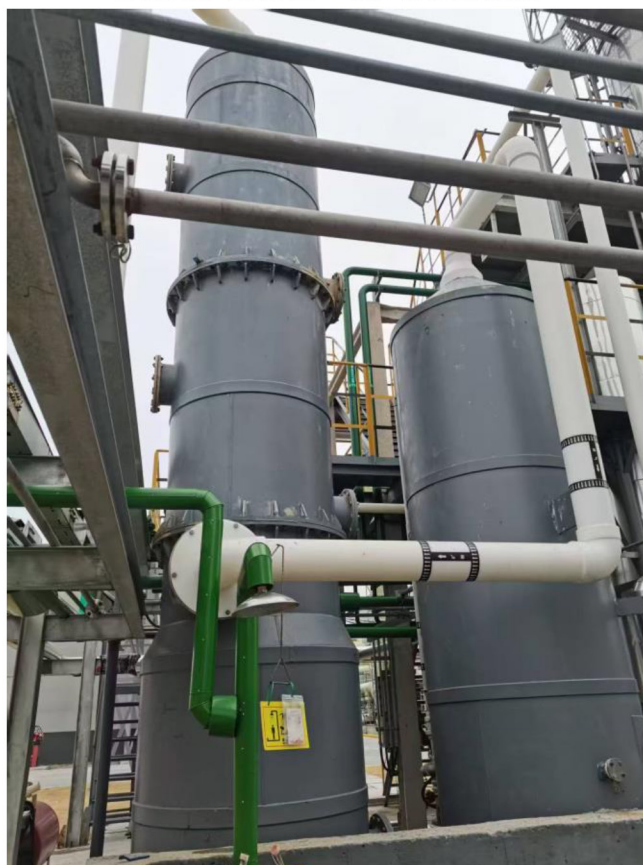
新增二级水吸收处理设施
