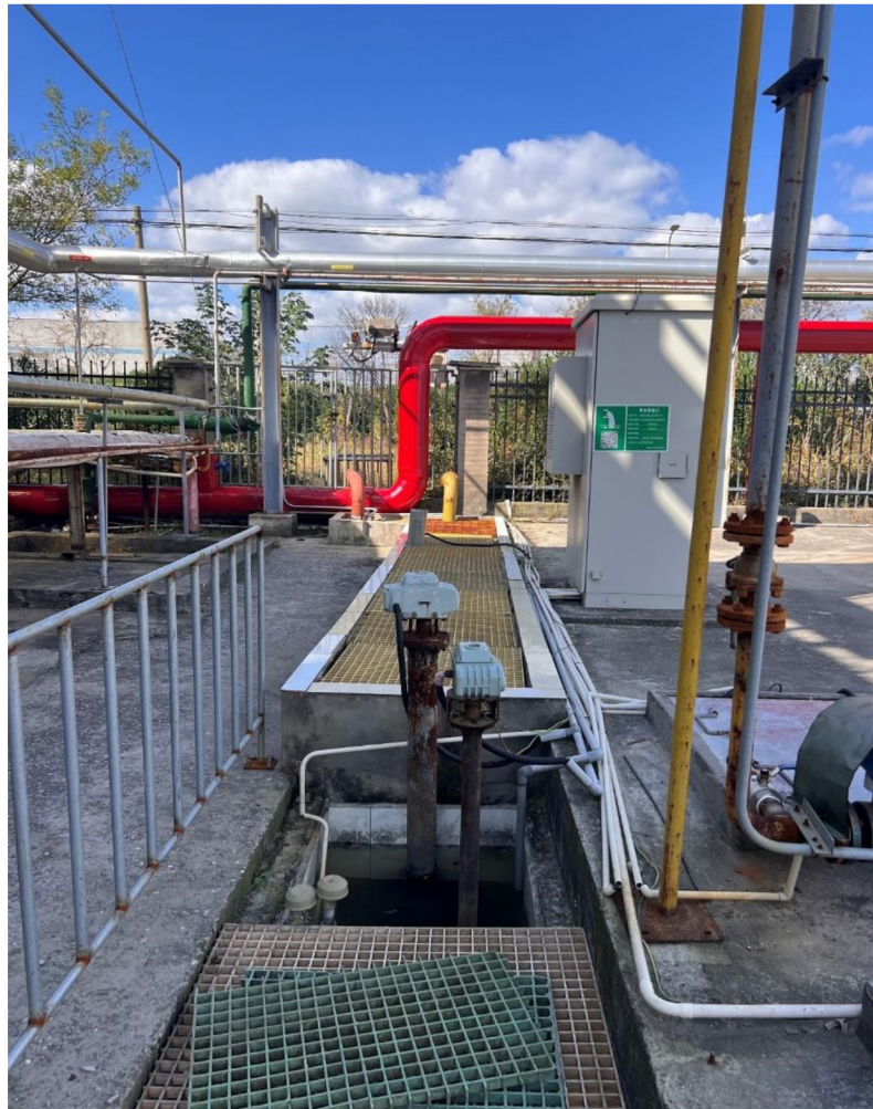
图 3-7 雨水排放口照片
