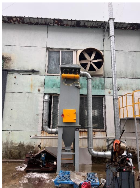
图 3-2 配料废气处理设施照片
