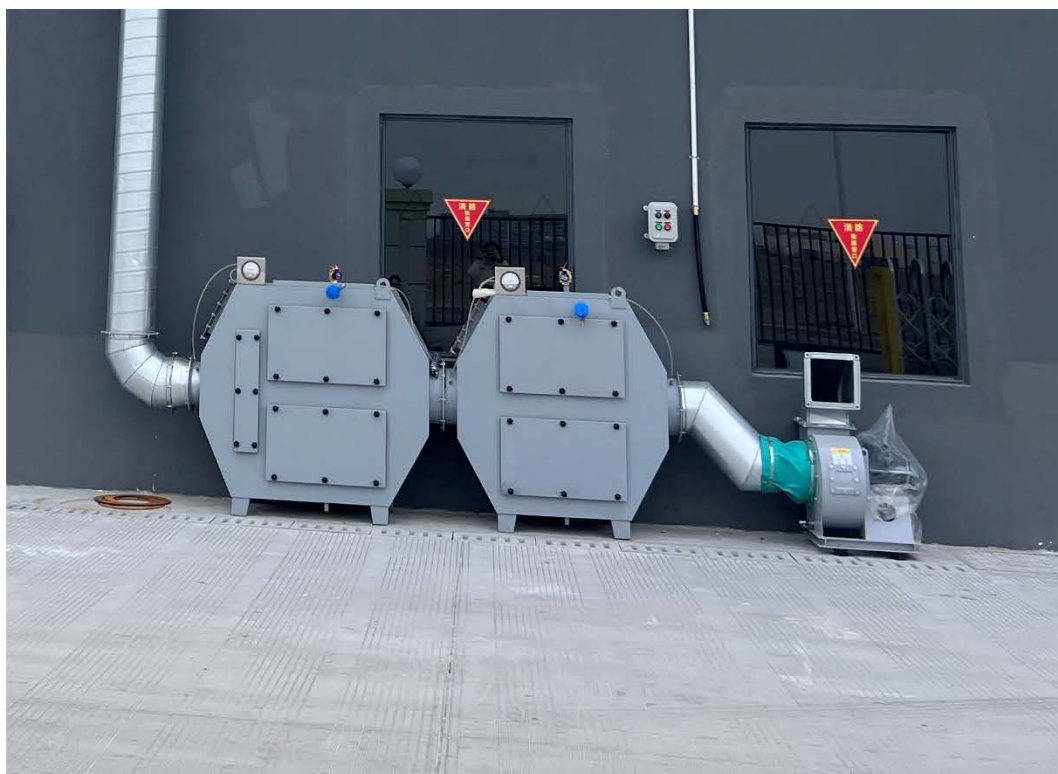
图 4-6 危废仓库废气处理设施
