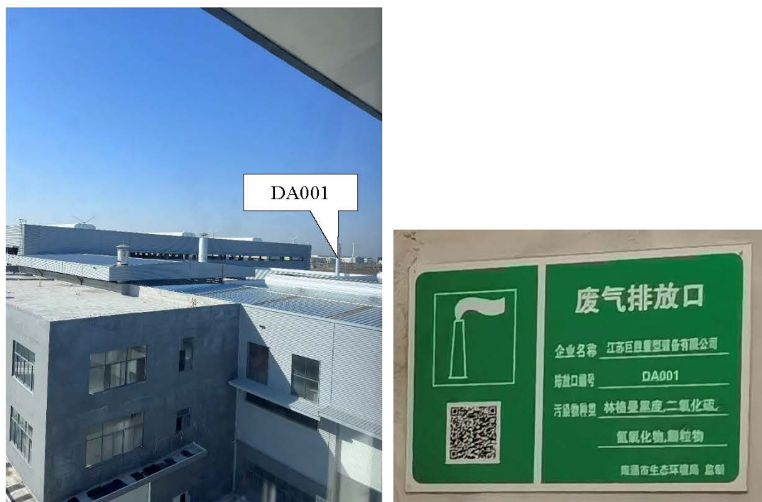
图 4.2-1 DA001 排气筒及标志牌图
