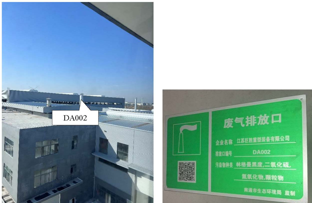
图 4.2-2 DA002 排气筒及标志牌图
