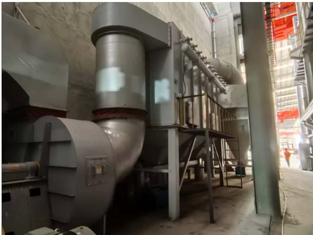
图 4-2 喷砂废气处理设施
