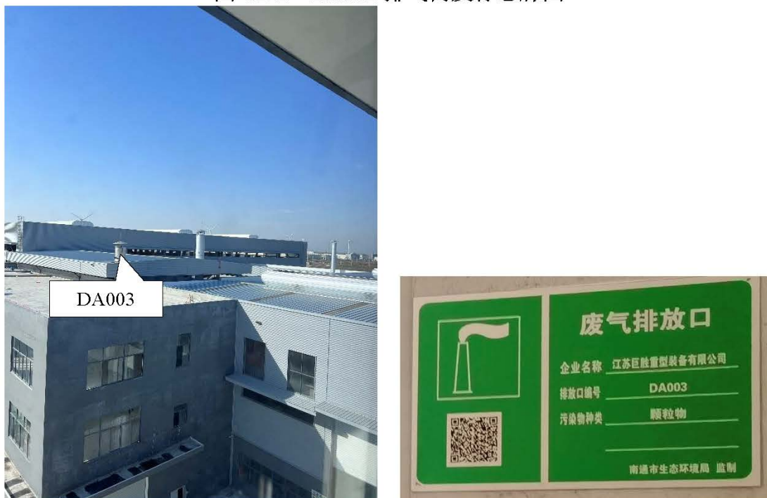
图 4.2-3 DA003 排气筒及标志牌图
