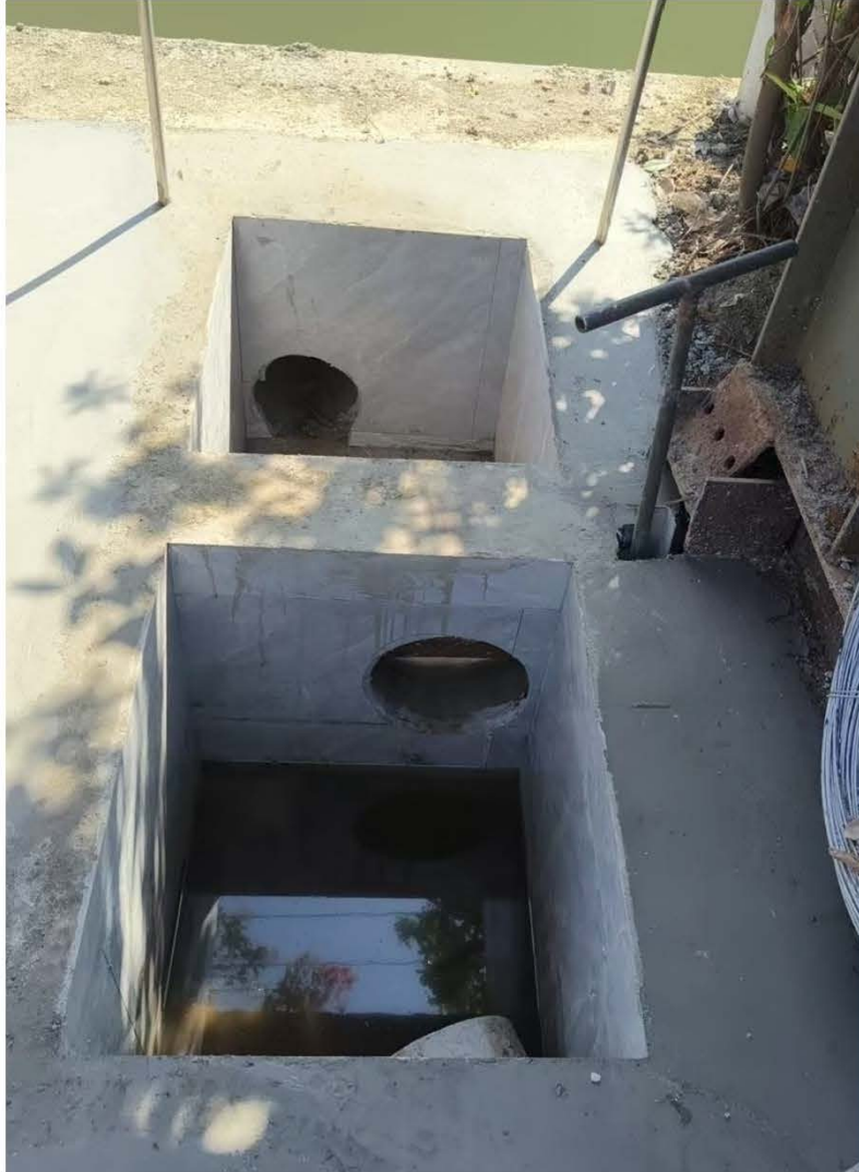
图 3-6 雨水排口照片
