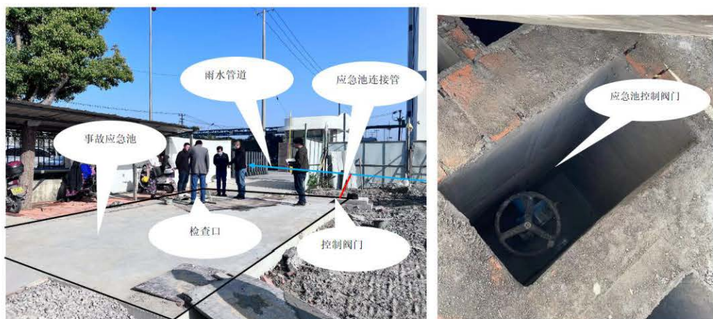
图 3-7 事故应急池及控制闸阀照片
