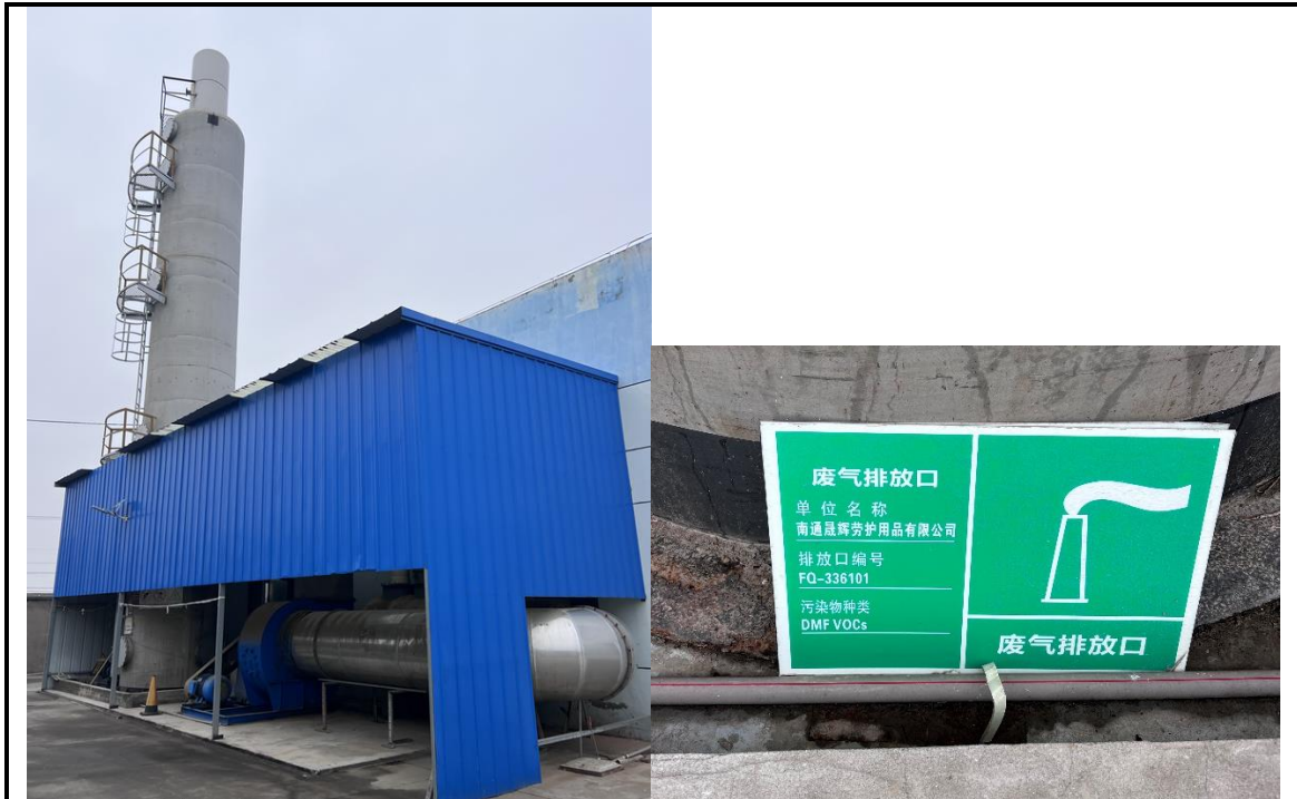
图 3-3 废气 1#排气筒及标牌照片
