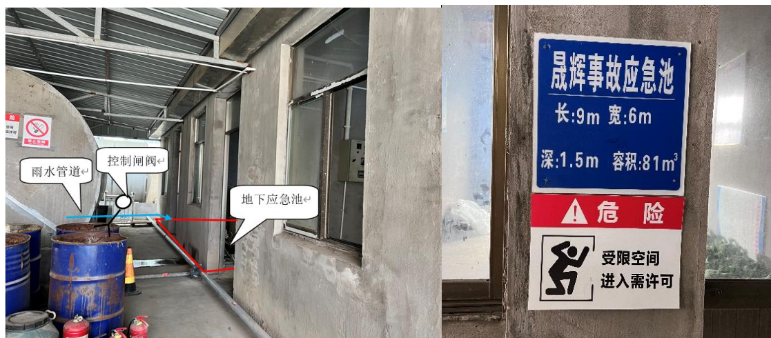
图 3-6 事故应急池及控制闸阀照片
