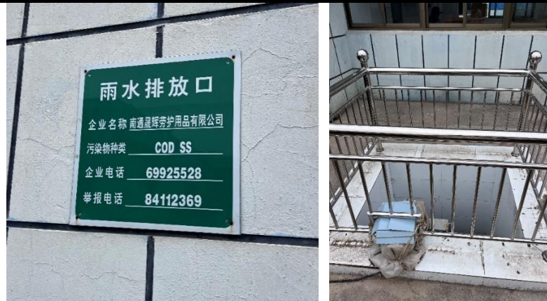
图 3-9 雨水排放口及标志牌照片
