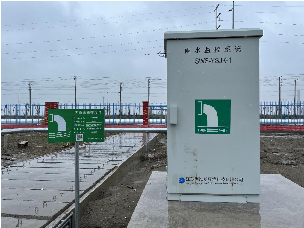
1#雨水排口照片
