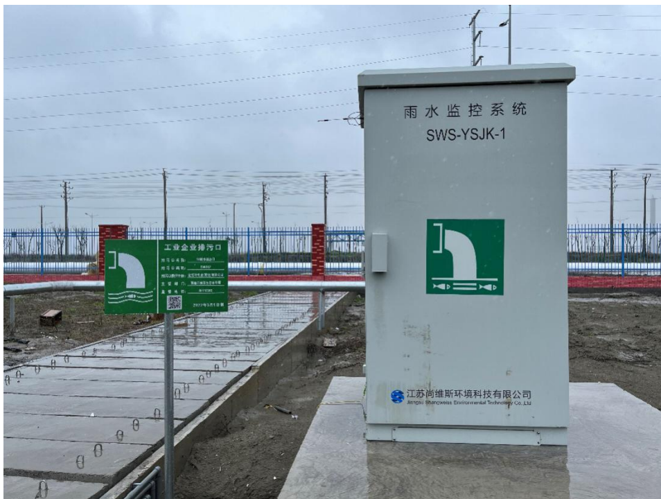
雨水排口自动监控系统照片
