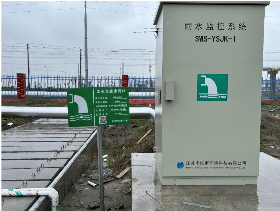
3#雨水排出口照片
