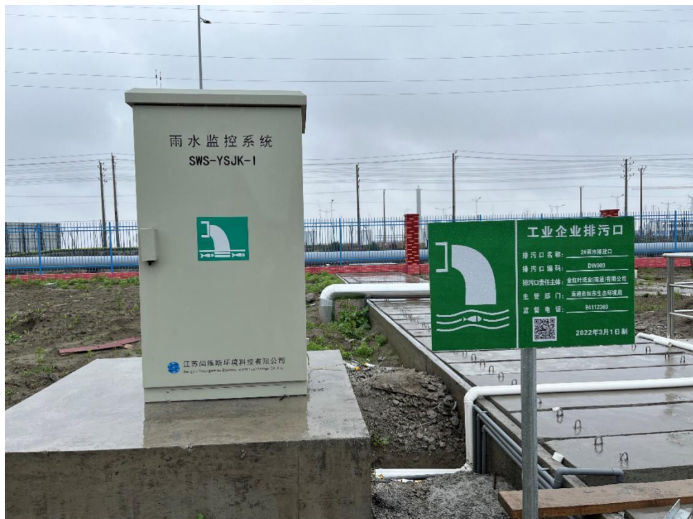
2#雨水排口照片
