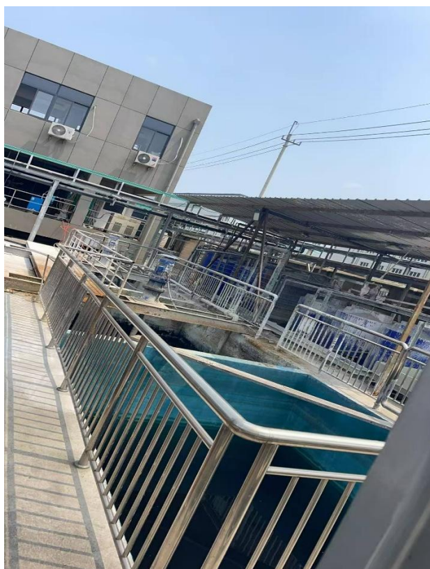
事故应急池照片
