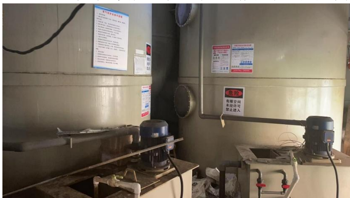
图4.1-6（2） 2#阳极氧化生产线工艺废气二级碱喷淋装置
