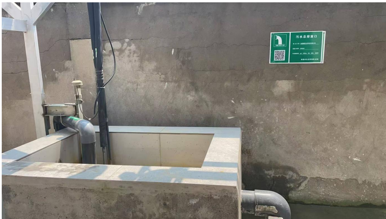
污水排口及标志牌照片
