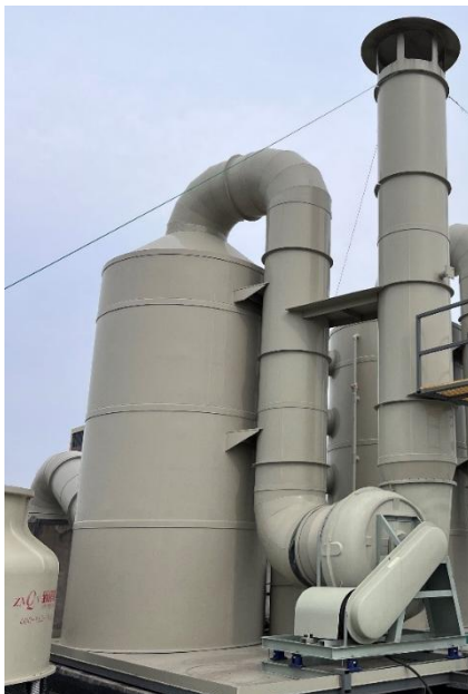
图4.1-6（5） 7#阳极氧化生产线化抛、中和废气二级碱喷淋装置
