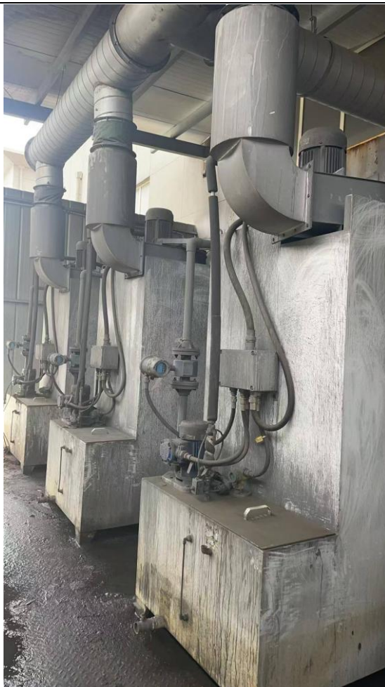
图4.1-6（10） 4#车间喷砂废气水浴除尘装置
