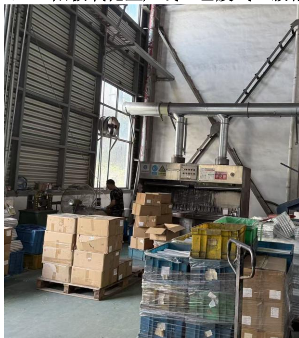
图4.1-6（8） 1#车间喷砂、抛丸废气水浴除尘装置
