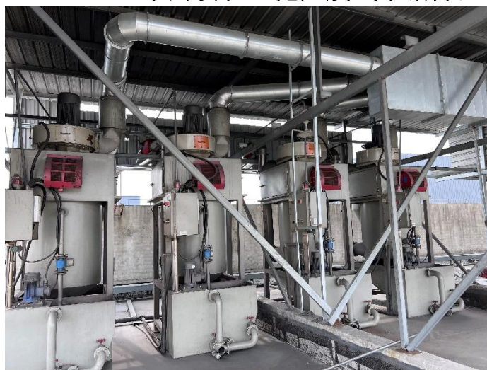
图4.1-6（9） 3#车间喷砂废气水浴除尘装置
