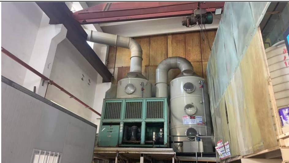
图4.1-6（4） 4#阳极氧化生产线工艺废气二级碱喷淋装置
