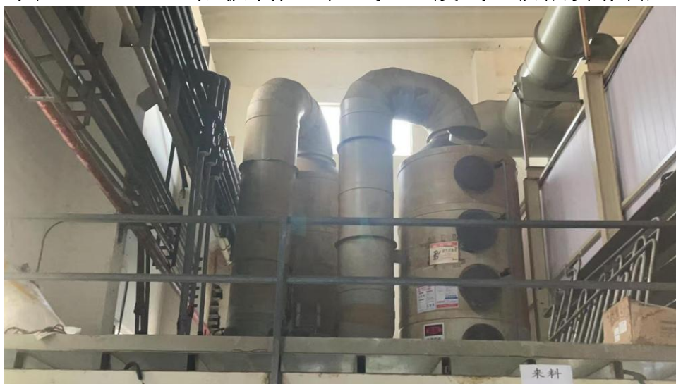
图4.1-6（3） 3#阳极氧化生产线工艺废气二级碱喷淋装置
