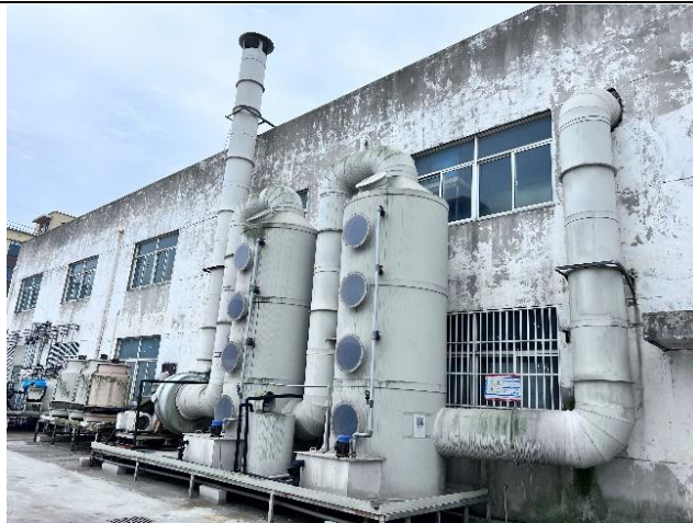
图4.1-6（7） 8#阳极氧化生产线工艺废气二级碱喷淋装置
