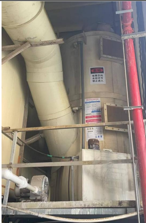
图4.1-6（1） 1#阳极氧化生产线工艺废气二级碱喷淋装置
