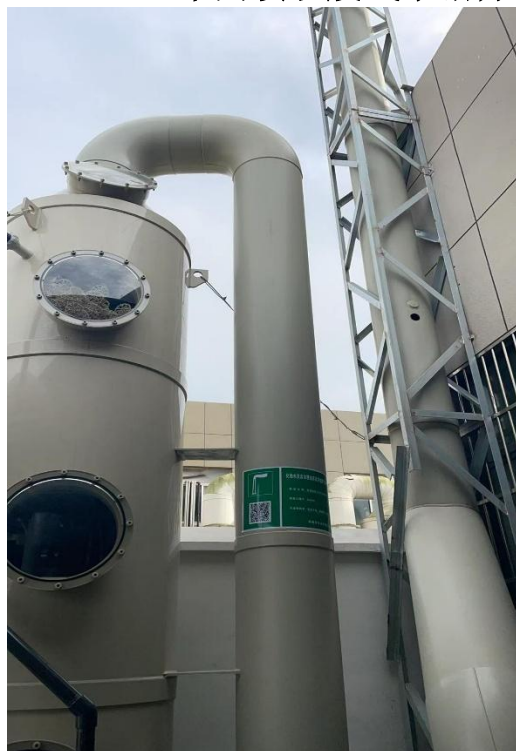
图4.1-6（11） 化抛水洗高浓槽液蒸发浓缩废气二级碱喷淋装置
