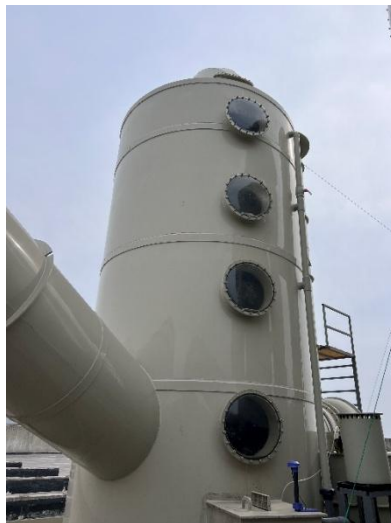
图4.1-6（6） 7#阳极氧化生产线阳极氧化废气二级碱喷淋装置
