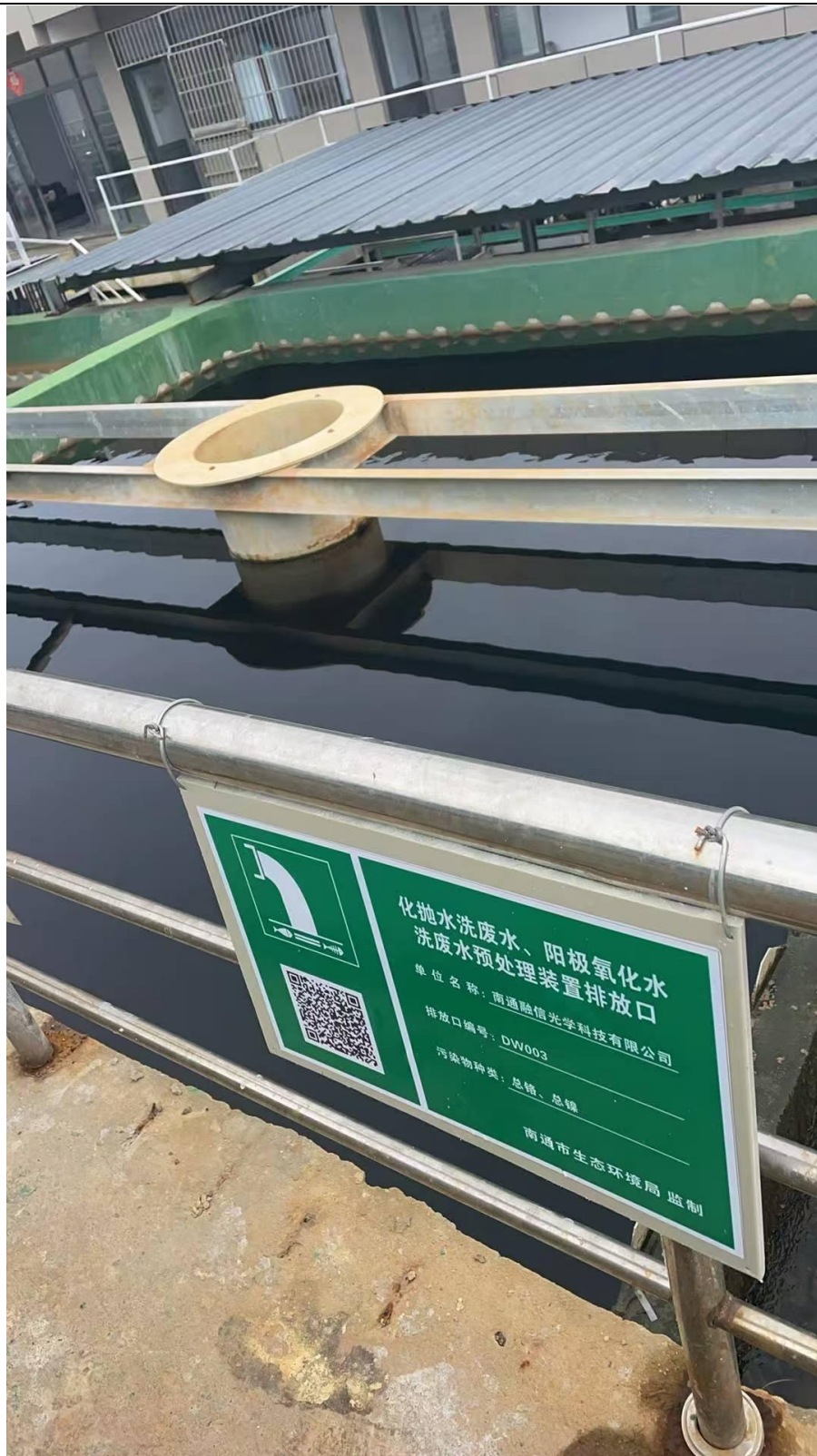
图4.1-4 阳极氧化生产线废水预处理装置
