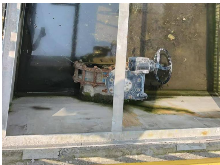
事故应急池控制阀门照片
