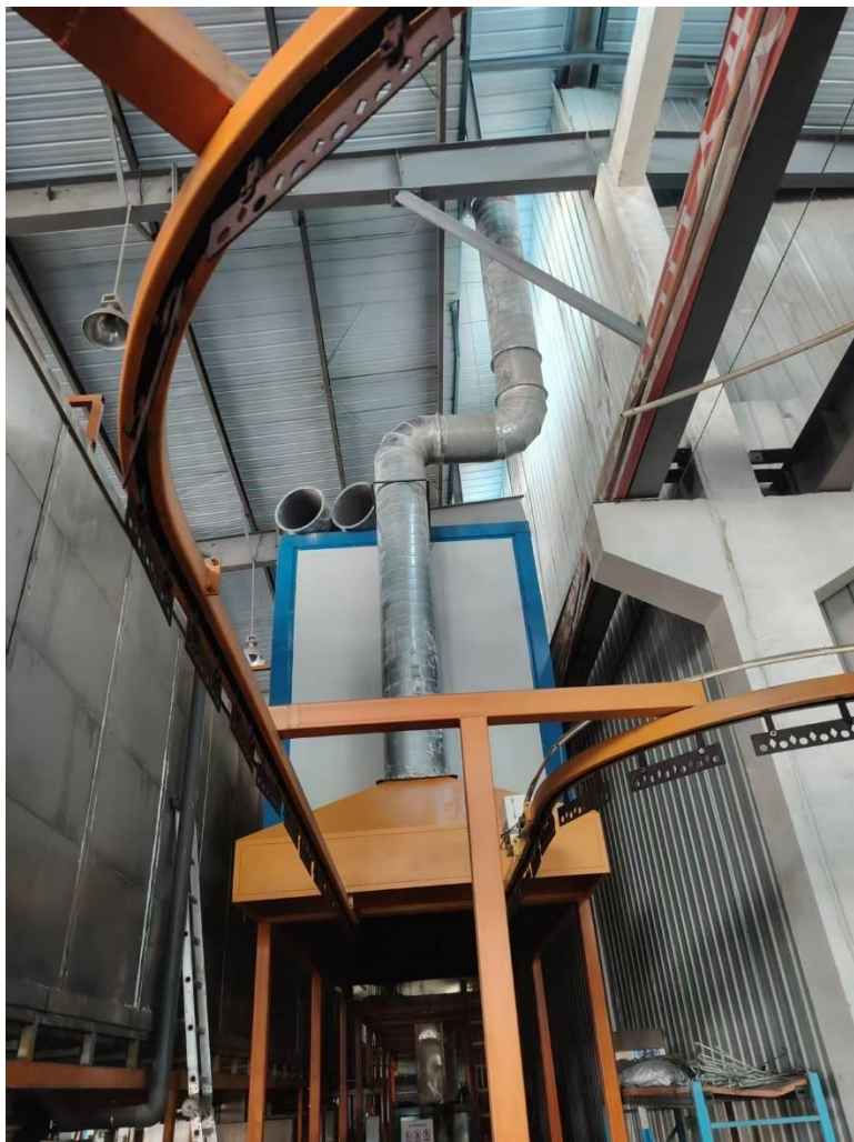
图 3-2 燃烧废气管道收集装置照片
