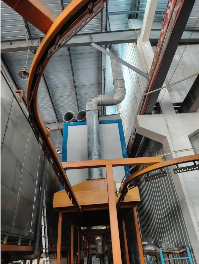
图 7-1 4#排气筒进口管道照片
