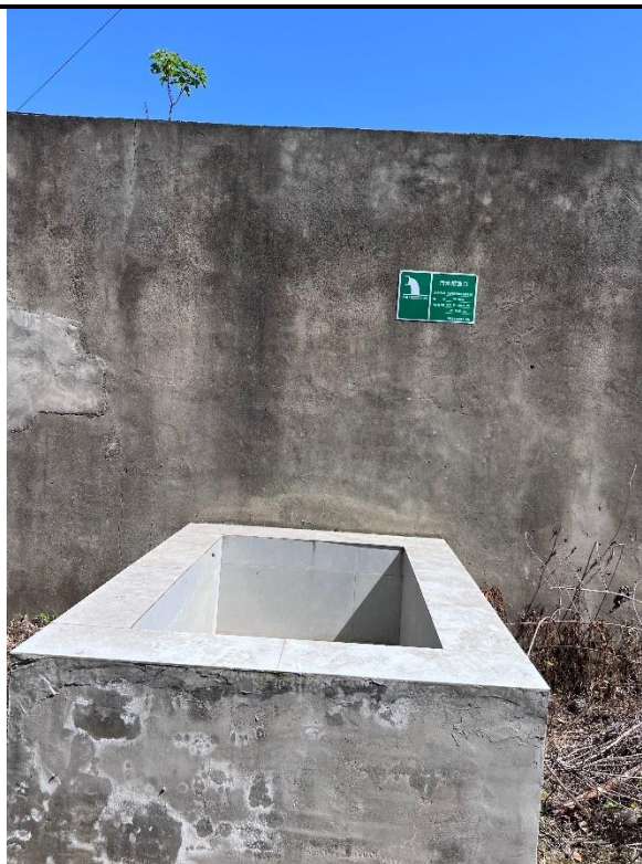
图 3-8 废水排放口及标志牌照片
