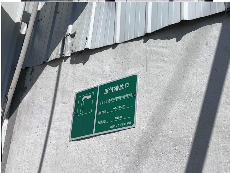
图 3-6 配料、混料、料仓呼吸废气处理设施 FQ-436201 排气筒标识牌照片
