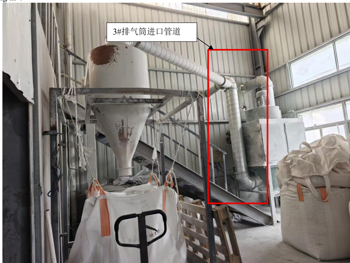
图 7-2 3#排气筒进口管道照片
