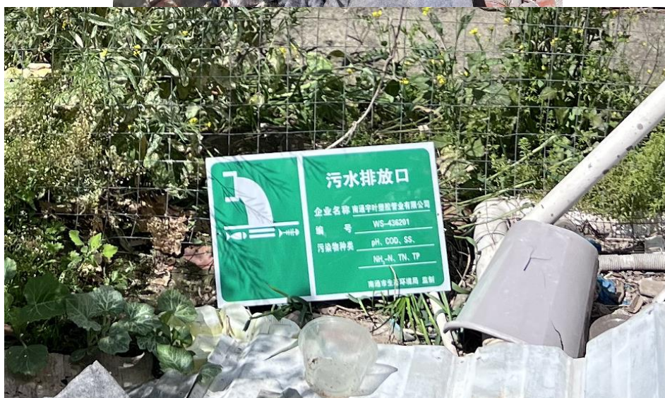
图 3-10 污水排口及标牌照片
