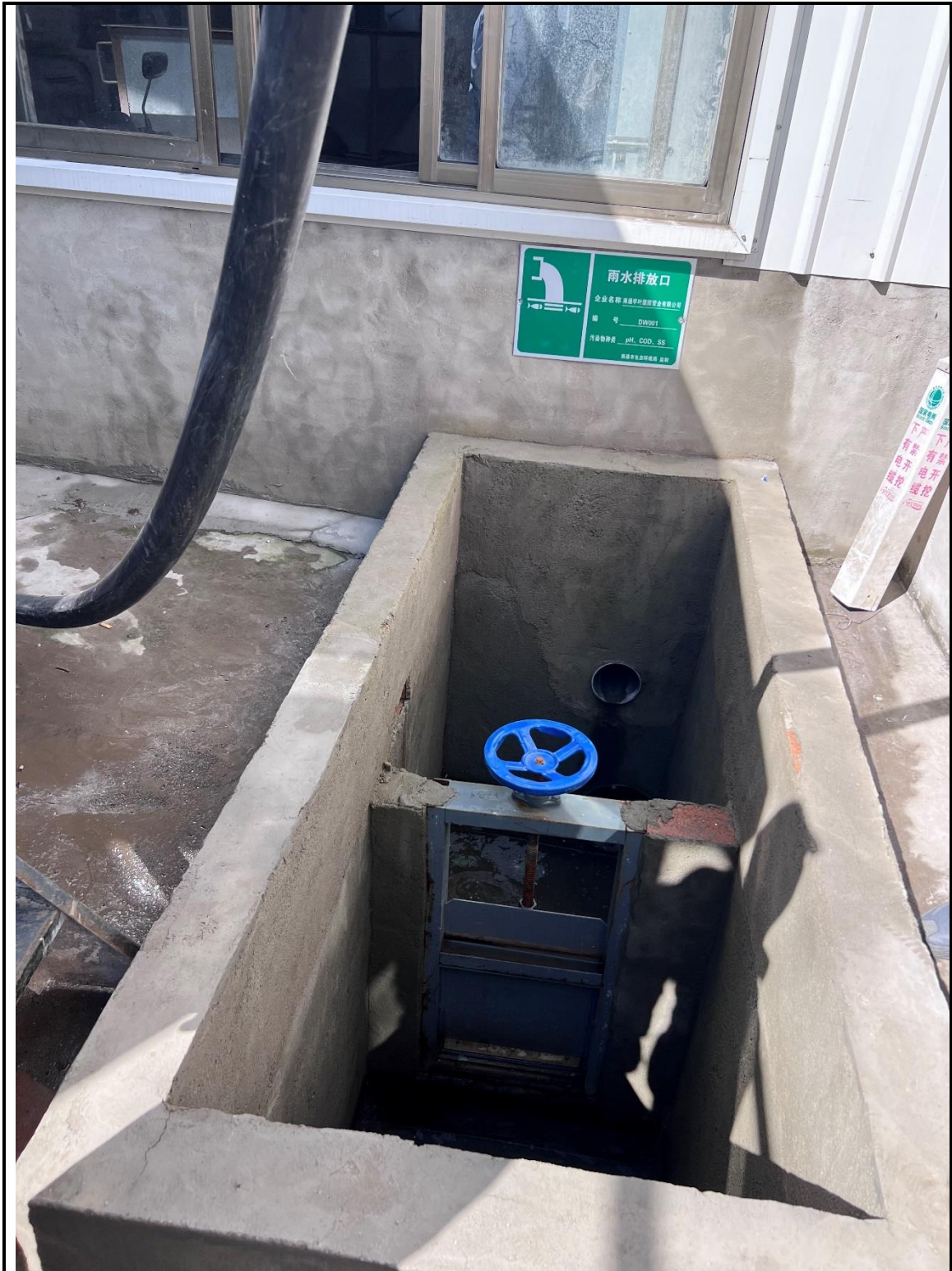
图 3-9 雨水排口及标牌照片
