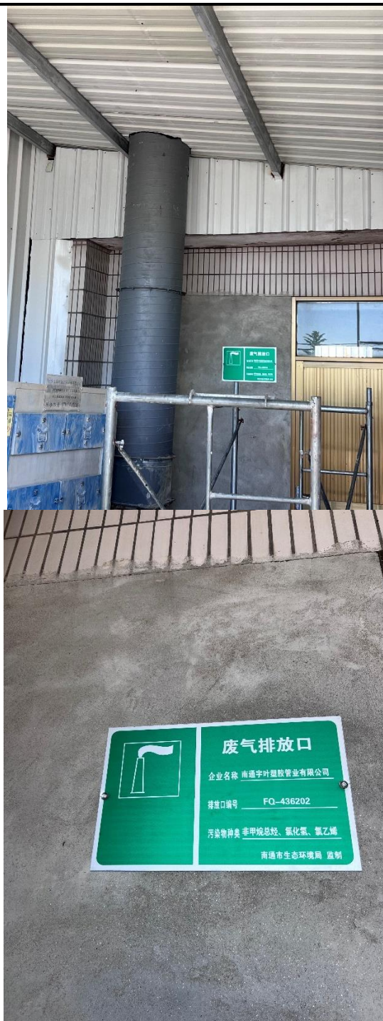
图 3-7 熔融挤出废气处理设施 FQ-436202 排气筒标识牌照片
