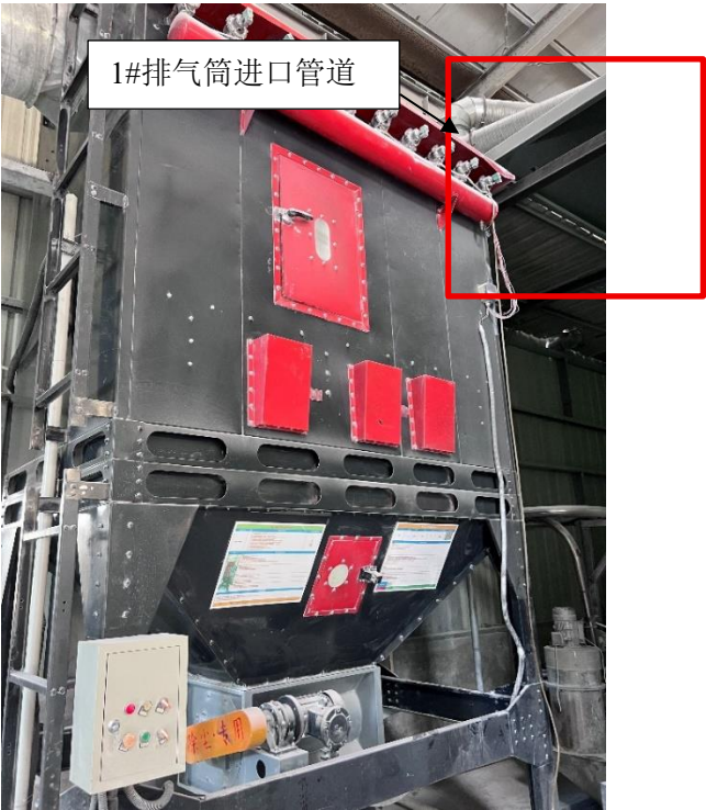
图 7-1 1#排气筒进口管道照片
