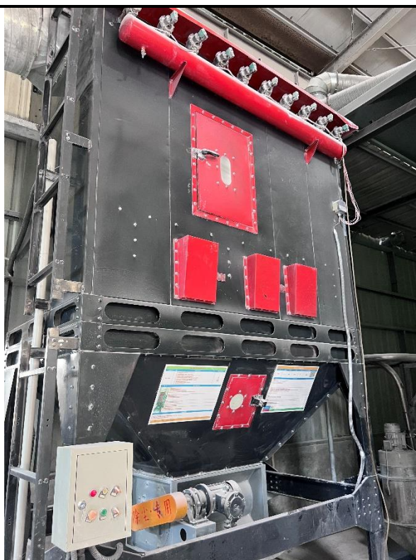
图 3-2 配料废气、混料废气、料仓呼吸废气合并废气处理设施照片
