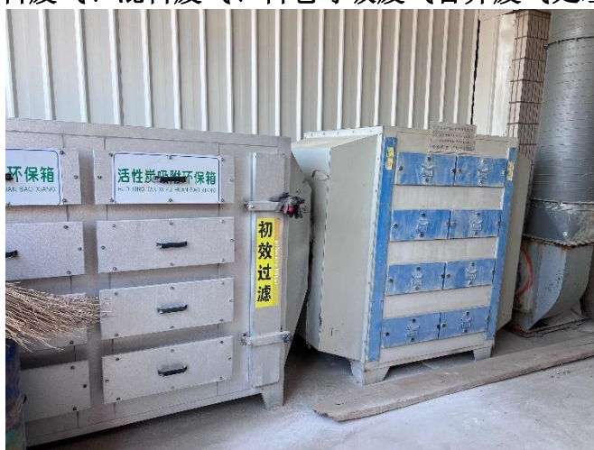
图 3-3 熔融挤出废气处理设施照片
